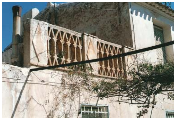
0273 – Antepecho de terraza lateral del edificio anterior construido con ladrillos y con una cierta elaboración (27-8-2000)
