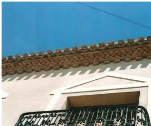
0429 – Edificio nº 5. Barandilla del balcón y cornisa (tipo 26) (27-8-2000)
