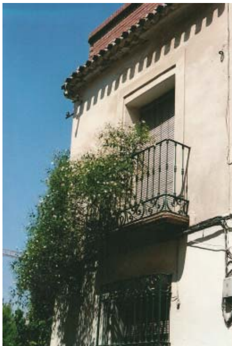
0385 – Edificio nº 32. Balcón de la planta superior con repisa de piedra de cantería (13-8-2000)
