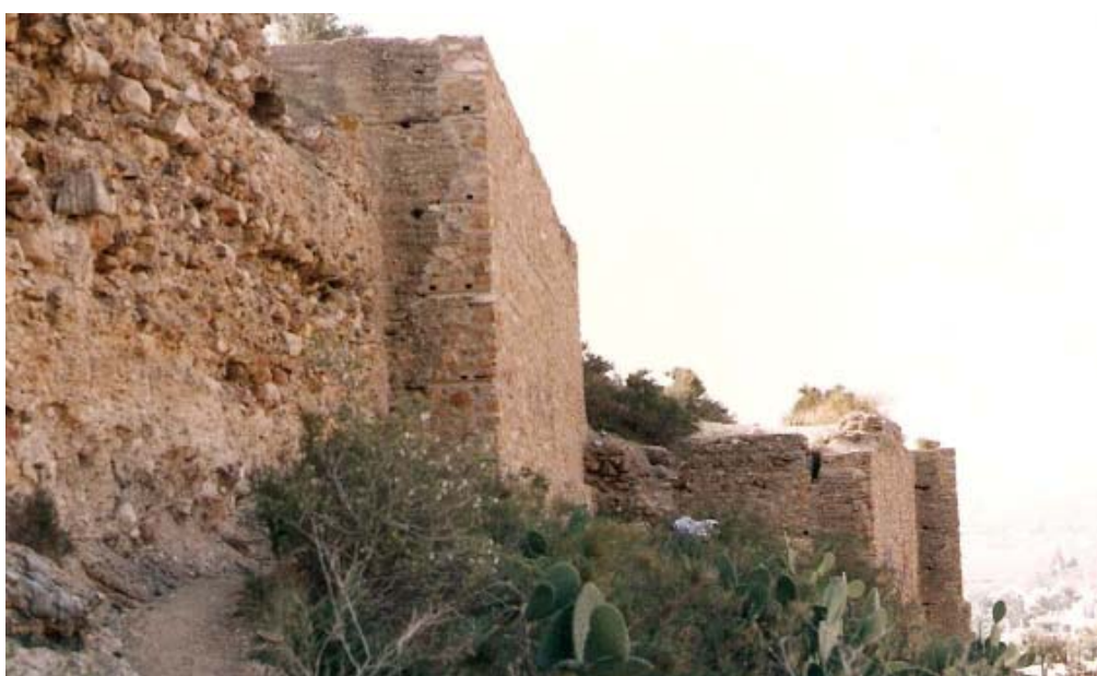
0157 – Contraste entre tramos de muralla restaurados y otros que todavía no lo han sido (marzo 2000)
