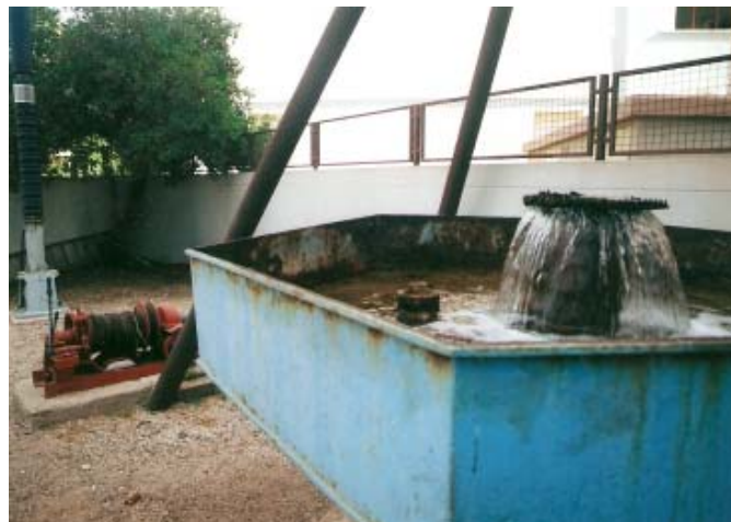
0407 – El agua termal saliendo del pozo como sobrante hacia las balsas (6-8-2002)
