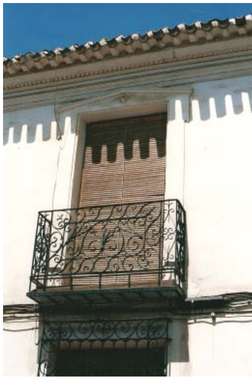
0360 – Edificio nº 12. Balcón con repisa de azulejos, adornos clásicos en el fajón del hueco y cornisa a base de molduras clásicas (tipo 39) (22-8-2000)
