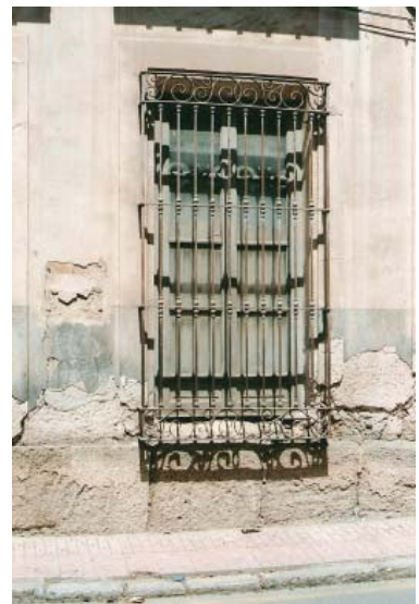
0353 – Edificio nº 10. Reja de ventana inferior y soleras de piedra de cantería (tipo B) (22-8- 2000)
