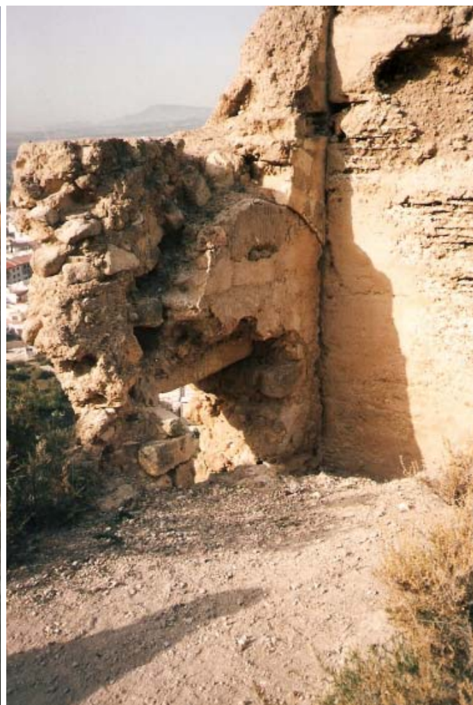
0162 – Interior de la torre de la fotografía anterior. Pueden apreciarse la mezcla de materiales y de composiciones constructivas así como el nivel de escombros existente (marzo 2000)
