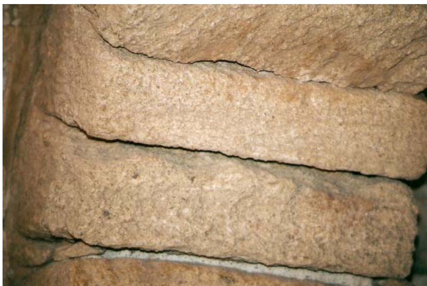
0173 – Dovelas de los arcos apuntados o góticos de la sala de la torre (27-12-2001)
