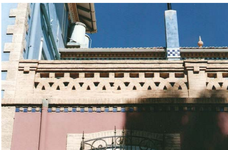
0240 – Elaborado antepecho de ladrillo de la terraza de la planta superior a base de intersecciones de arcos de medio punto (20-9-2000)
