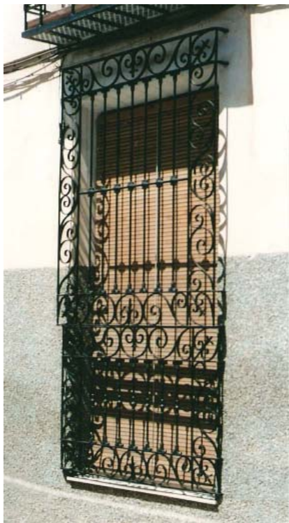
0359 – Edificio nº 12. Reja de ventana (tipo B) con una cierta elaboración en planta baja y balcón metálico con repisa de azulejos (22-8-2000)
