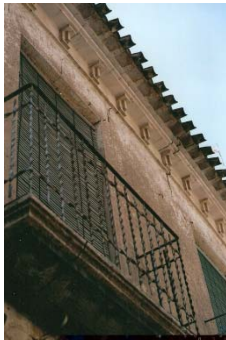
0382 – Edificio nº 29. Balcón de piedra de cantería apoyado en cartelas de refuerzo adosadas, cerrajería uniforme (tipo C) y cornisa de ladrillo (tipo 32) con piezas cerámicas (13-8-2000)
