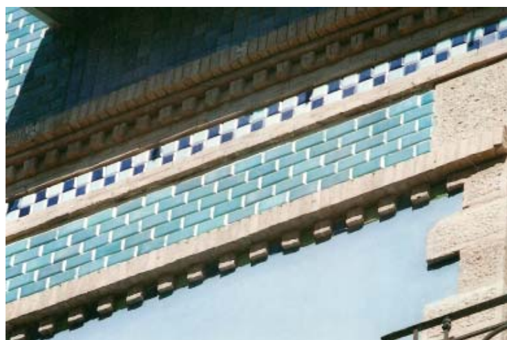
0242 – Diferentes tipos de losetas vidriadas utilizadas en el revestimiento superior de la fachada y fajones de ladrillo en los cercos (20-9-2000)
