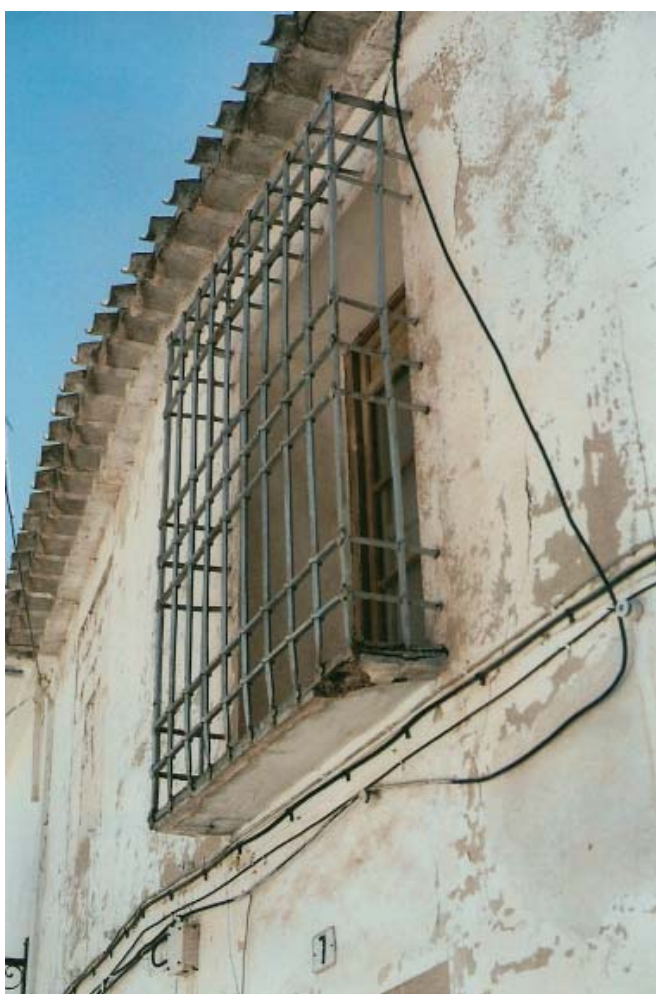
0285 – Edificio nº 7. Reja original (tipo A) de perfil cuadrado macizo con repisa original de ladrillo (22-8-2000)
