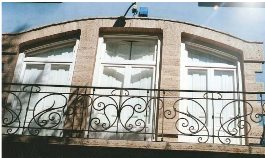
0239 – Balconada en fachada principal con repisa de cantería y ménsulas del mismo material con baranda modernista (20-9-2000)
