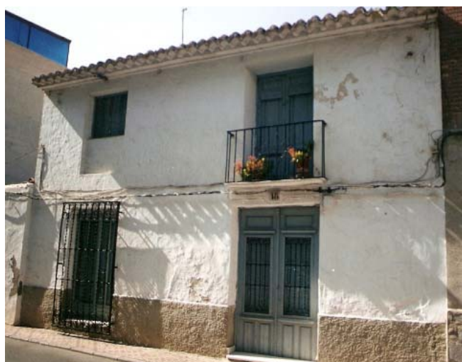
0224 – Edificio nº 18. Tipología característica (tipo II). Vivienda de dos plantas con uso mixto tardío de la planta superior, por adaptación parcial de la cilla o cámara. Presenta puerta sustituida (posiblemente de tipo C a tipo F), una cerrajería (tipo C) adosada posteriormente y un balcón de losa de cantería (18-8-2000)
