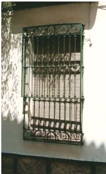
0384 – Edificio nº 32. Reja de la planta baja (tipo B). Se aprecian los sillares de cimentación rehundidos con respecto al paramento de cerramiento objeto de sucesivos revestimientos (13-8-2000)
