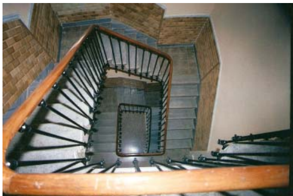
0244 – Escalera con barandilla simple, soportes de plomo y pasamanos de madera. Los peldaños son de piedra artificial, mesetas de loseta hidráulica originales y zócalo de piezas vidriadas (18-9-2000)
