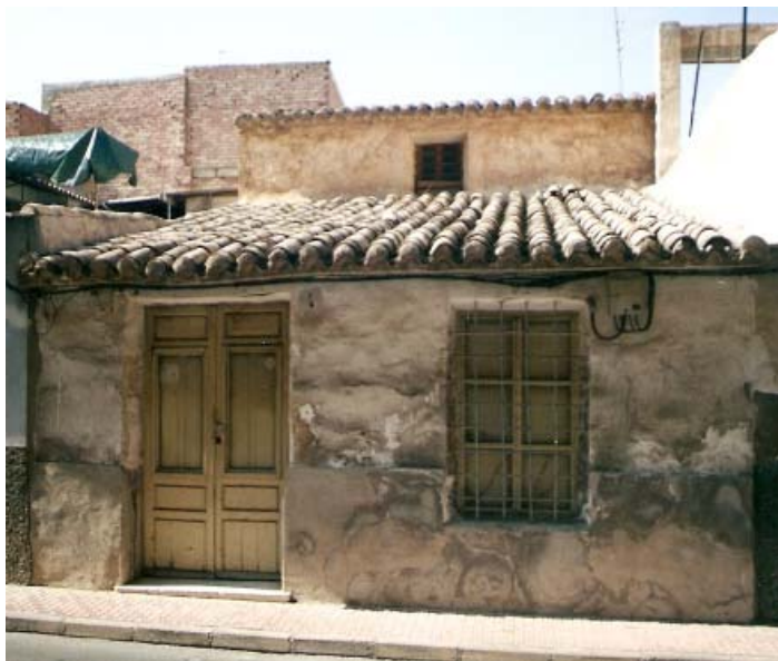
0223 – Edificio nº 4. Tipología característica (tipo I). La vivienda presenta un camaranchón, cilla o algoifa en segunda crujía y sustituciones de carpintería en puerta (de tipo B a tipo F) y ventana de fachada (18-8-2000)
