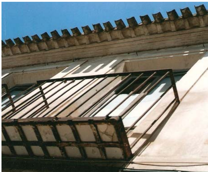
0354 – Edificio nº 10. Ejemplo de balcón realizado a base de plantilla metálica y loseta hidráulica (13-8-2000)
