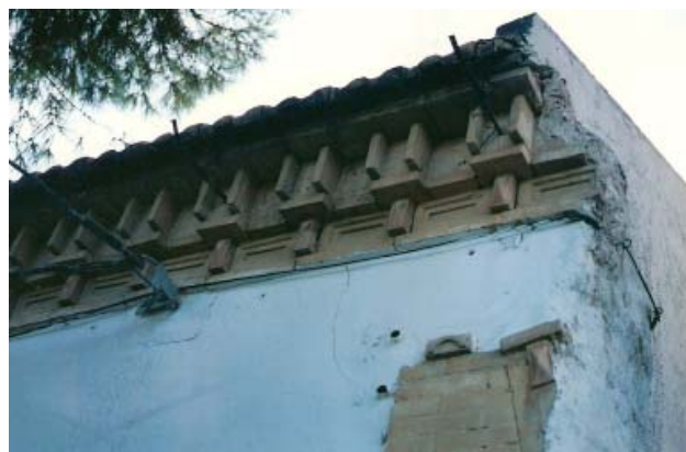
0403 – Parte inferior del alero con la cornisa (tipo 36) realizada a base de ladrillo y piezas cerámicas. La parte del almacén que todavía existía ha sido derribada en la Semana Santa del año 2010 (18-9-2000)
