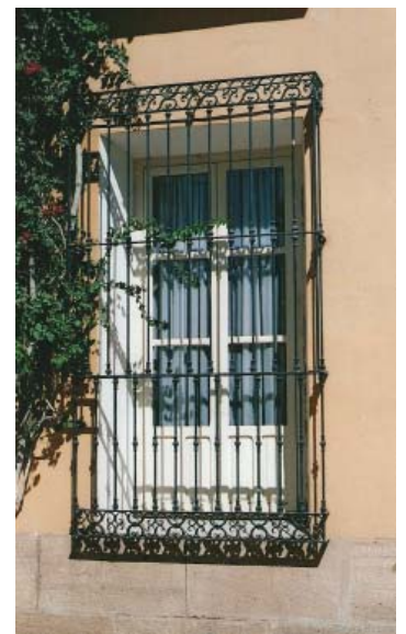
0279 – Reja de ventana a base de redondos con engarces de plomo (tipo B) (22-8-2000)
