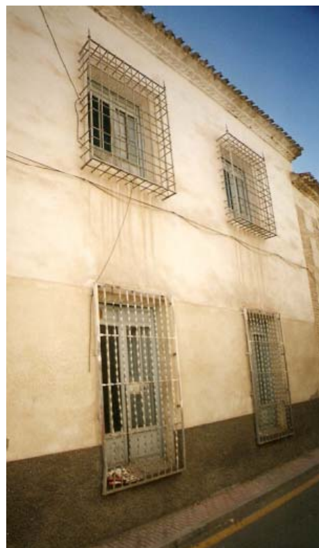
0288 – Edificio accesorio. Rejas de dos tipos (tipos A y C), posiblemente por acondicionamiento de huecos en la planta baja en época tardía (18-8-2000)
